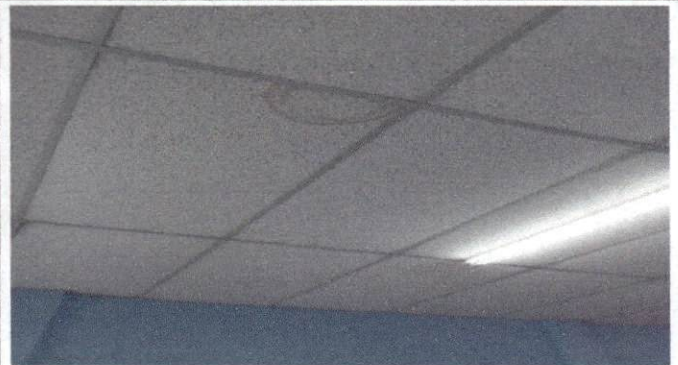
Foto 2: Filtración de agua en el aula de segundo sección B
