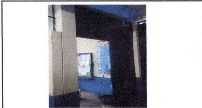
Foto 4: puerta salon de parvulos necesita cambio, en mal estado
