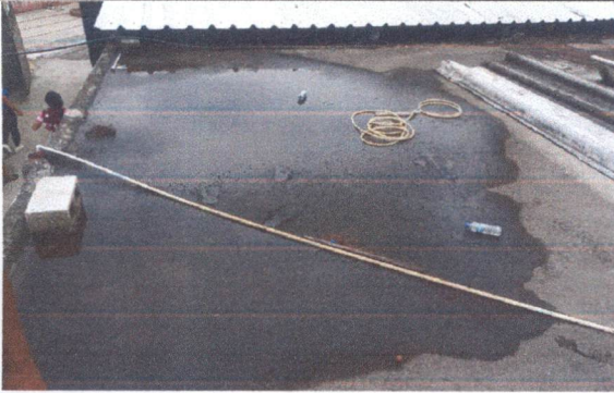
Foto 3: FILTRACION EN LOSA BIBLIOTECA
