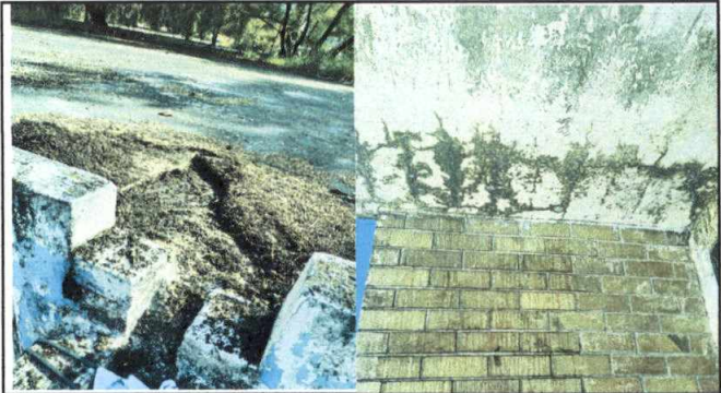
Foto 2: Bajadas de agua rotas
