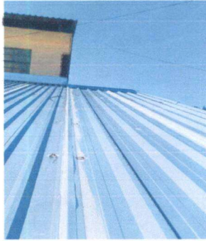
Foto 1: Reparación de techo de lámina debido a filtraciones por una mala instalación (poco espacio de traslape y filtración en tornillos)
