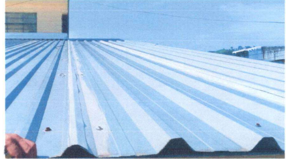
Foto 2: Reparación de techo de lámina debido a filtraciones por mala instalación
