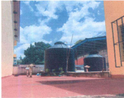
Foto 3: Reinstalación de depósito de agua existente, e instalación de bomba y tanque hidroneumático.
