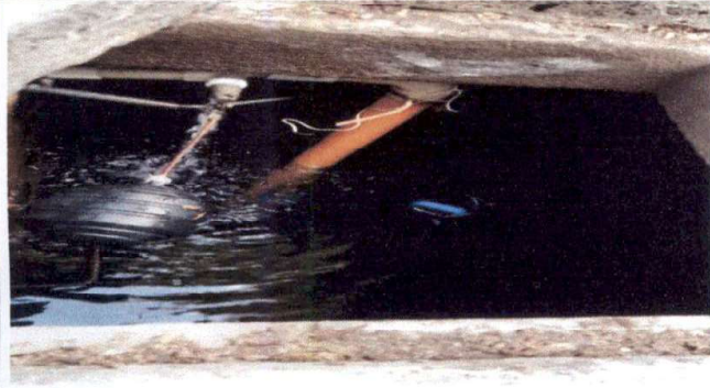
Foto 1: Cisterna deteriorada por falta de mantenimiento.
