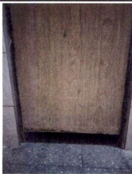
Foto 11: Puertas de baños de niños deterioradas
