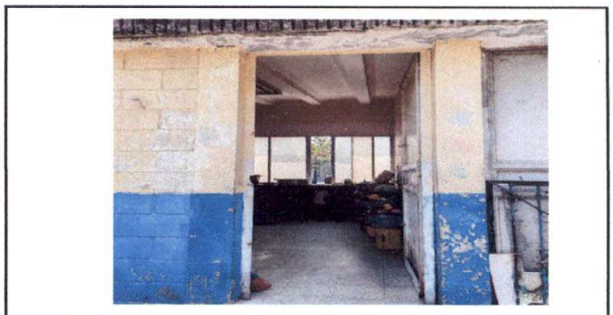
Foto 6: La pintura de la cocina está deteriorada.
