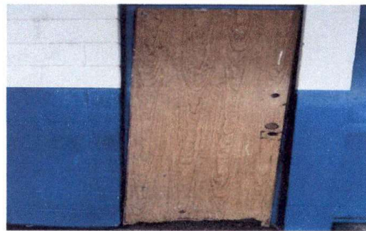
Foto 12: Puerta deteriorada en sanitarios de niños
