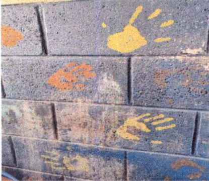
Foto 7: Cocina, muros interiores presentan deterioro en pintura.
