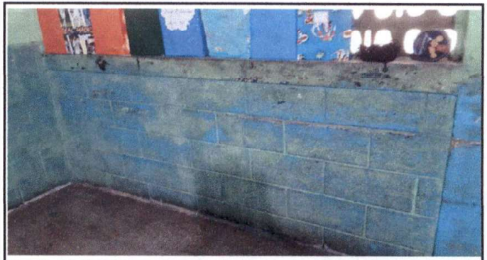
Foto 4: Paredes de aulas con pintura deteriorada.
