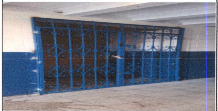
foto 2 instalacion de puerta de rejacolor azul en aula que funcionara como bodega
