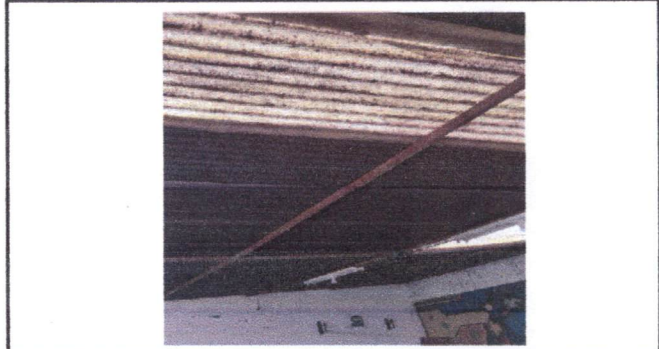
Sustitución de lámina para lámina troquelada 5 mt por 10 mt. En patio de 1er. Nivel
