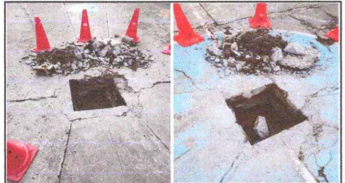
Foto 4: CAMBIO DE DOS REPOSADERAS DE PATIO, YA QUE ESTAN RAJADAS Y EN MUY MAL ESTADO.
