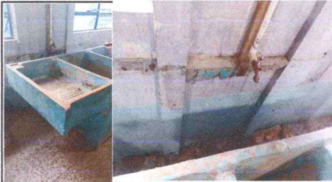
Foto 3: SUSTITUCIÓN DE PILA DE CONCRETO EN COCINA, YA QUE ESTA RAJADA Y EN MAL ESTADO.
