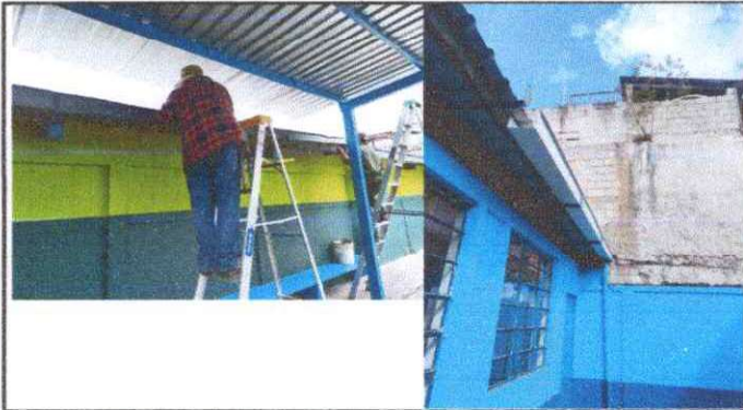
Foto 1: SUSTITUCION DE CANALES YA QUE ESTAN OXIDADOS Y EN MUY MAL ESTADO.
