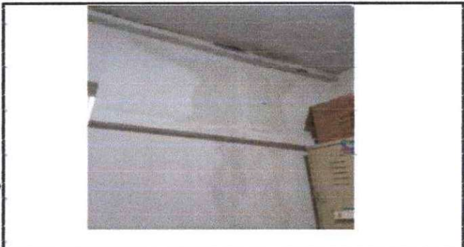
Foto 4: Sustitucion de repello de todas las paredes y cielo de la oficina de supervision
