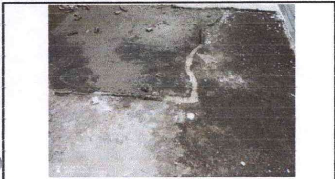
Foto 1: Remoción de mezon existente, limpieza y elaboración de pañuelos de mezon nuevos, impermeabilización de área
