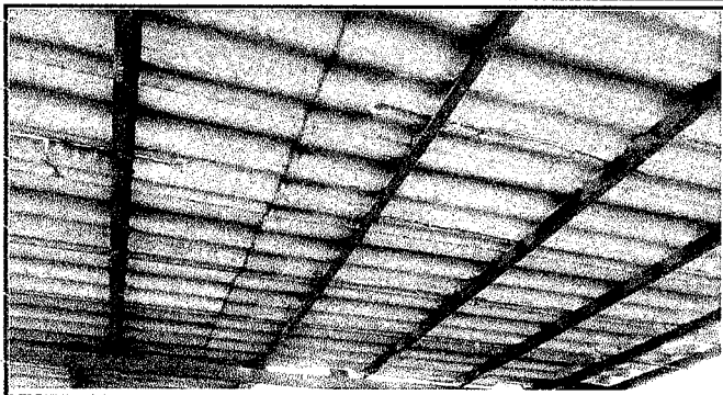
Foto1: Sustitución de láminas, ya que todas estan grietadas y rotas.
