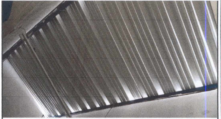
proteccion de enrejado en salon de computo en segundo nivel
