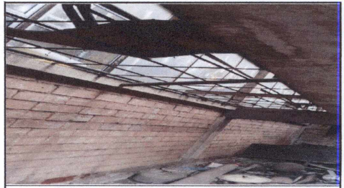
Reforzar reja de hierro de proteccion bajo modulo de concreto en salon de computo e instalar lamina para proteccion de lluvia
