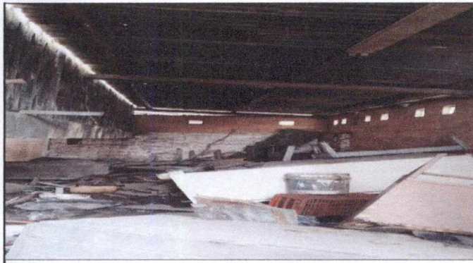
Desinstalar lamina y estructura actual y suministrar lamina de aluzin calibre 26 troquelada y estructura metalica nueva ( costanera acuachada)
