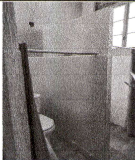
FOTO 3: FABRICACIÓN DE PARED PREGABRICADA EN SANITARIOS DE NIÑOS. ÚNICAMENTE SE INSTALARON 9 M2 DE LOS 22.35 INDICADOS EN EL PARA-FOR-122. SE DEBERÁ INSTALAR LOS 13.35M2 FALTANTES Y DE NO EXISTIR ÁREA DISPONIBLE, INVERTIR ESE MONTO EN OTRA NECESIDAD DEL ESTABLECIMIENTO
