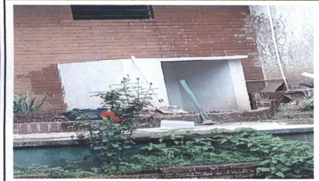
INSTALACION DE TUBERIA DE AGUA POTABLE PARA BOMBA Y ROTOPLAS REPARACION Y MANTENIMIENTO DE CISTERNAS / DEPÓSITOS DE AGUA TODO NUMERAL # 18 Y 18.1, 18.2, 18.3, 18.4
