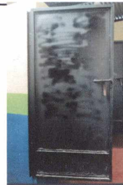
Foto 6: puerta actual en sanitario de niñas
