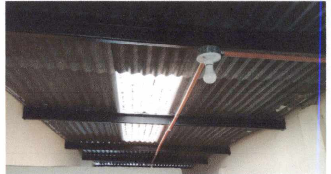
Foto 4: techo actual en sanitario
