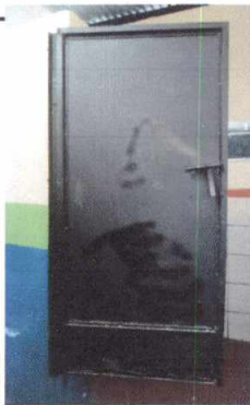
Foto 5: puerta actual en sanitario de niñas
