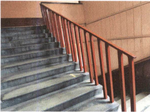
Foto 1: Remosamiento Baranda gradas.
