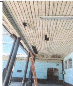
Foto 6: MODULO III - Panoramica de estado de machimbre en corredor patio juntas civicas.
