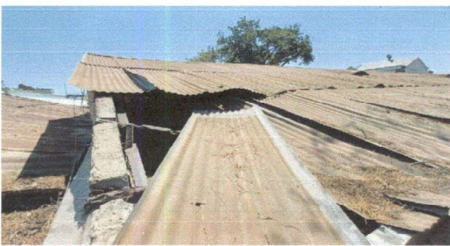
Foto 3: MÓDULO II - Estado de lamina en corredor patio juntas civicas
