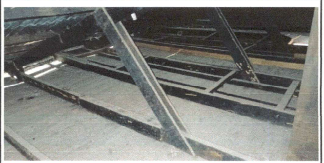
Foto 2: MÓDULO I - Estado de estructura de soporte interna salon de clases patio principal.
