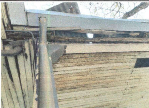
Foto 5: MÓDULO IV - Estado de machimbre en corredor patio juntas civicas.
