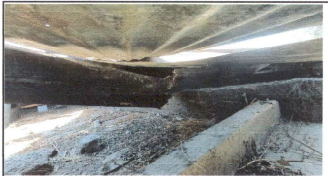
Foto 4: MÓDULO II - Estado de estructura de soporte interna en corredor patio juntas civicas.
