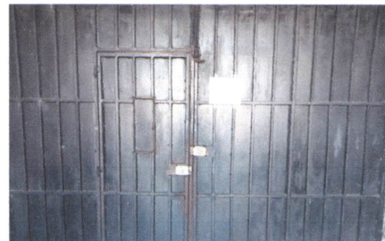
Por humedad no se ha iniciado el trabajo de lijado y pintura. Se necesita un ambiente seco para que a pintura nueva no se dañe.
