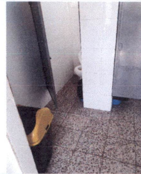
Foto 4: RENGLÓN 10 "SERVICIOS SANITARIOS Y SUS ACCESORIOS"
