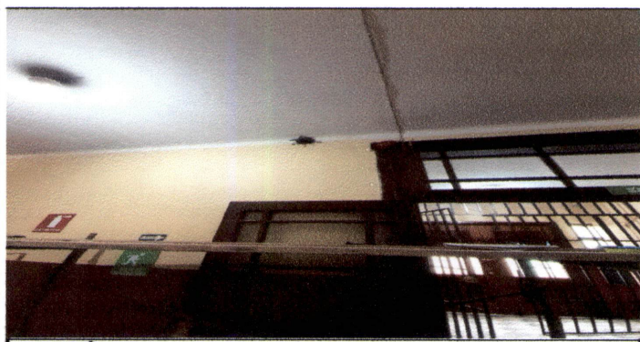
UBICACIÓN DE CAJA DE REGISTRO GENERAL
