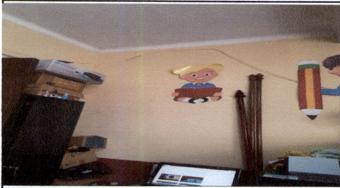
CABLEADOS SOBRE PUESTOS ACTUALES
