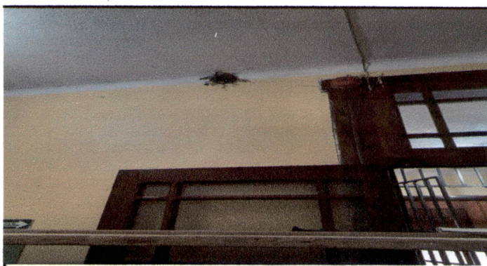
UBICACIÓN DE CAJA DE REGISTRO GENERAL
