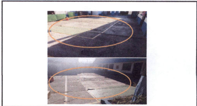
Modulo IV: Loza del patio en mal estado
