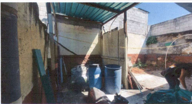
Foto 5: Estructura de la cocina en mal estado
