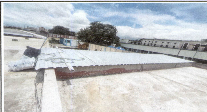
Foto 1: Sustrucción de láminas de zinc en el área de techado de entrada a sanitarios y cocina, por láminas de aluzinc calibre 26.
