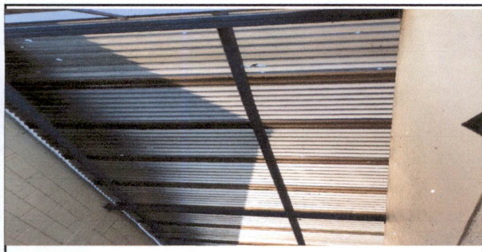
Foto ÍTEM 1.2: Sustitución de láminas de plástico en el área de techado de bodega de implementos de física que se encuentran perforadas y en mal estado. Por lámina de aluzinc calibre 26
