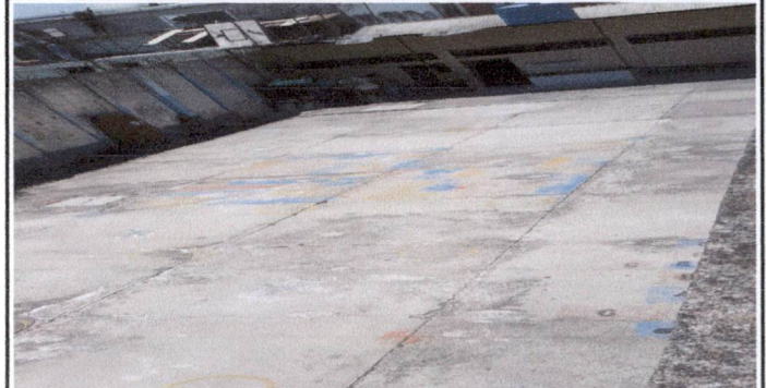
FOTO ÁREA 2: Reparación de losa de patio 1 que se encuentra levantada por raíces de árboles.
