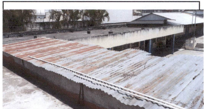
Foto1.1: Sustitución de zinc en el área de techado de sanitarios que se encuentran dobladas y en mal estado por el peso de las ramas de los árboles. Por láminas de aluzinc calibre 26.
