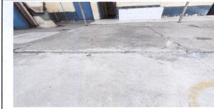
FOTO ÁREA 2: Reparación de planchas de concreto de patio 1 que se encuentra levantada por raíces de árboles.
