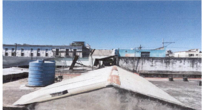
Foto ÍTEM 1: Sustitución de láminas plásticas en la sala de maestras que se encuentran en mal estado por láminas de aluzinc calibre 26.
