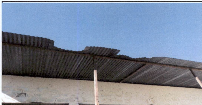
Foto ÍTEM 1.1: Sustitución de láminas de zinc en el área de techado de sanitarios que se encuentran dobladas y en mal estado por el peso de las ramas de los árboles por láminas de aluzinc calibre 26.
