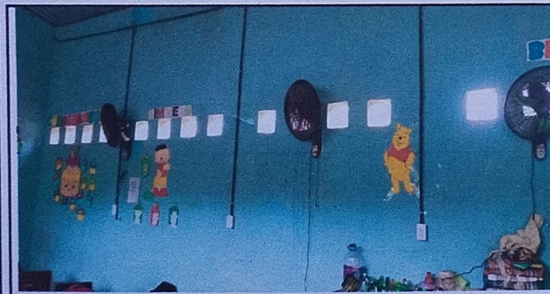
Foto 5: Sistema eléctrico instalado
