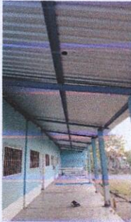
Foto 1: CUBIERTA DE LAMINA: Sustrucción de lámina y capote
