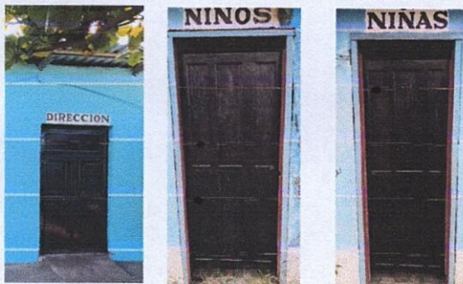
Foto 3: PUERTAS DE METAL: Sustrucción de puerta y en servicios sanitarios
