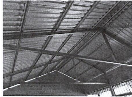
Foto 2: 2.2 Sustitución de estructura de soporte de madera, por metal en aula y cocina
