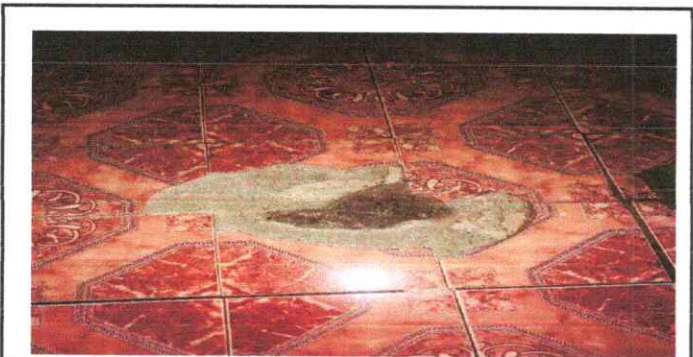
Foto 5: Piso cerámico dañado
