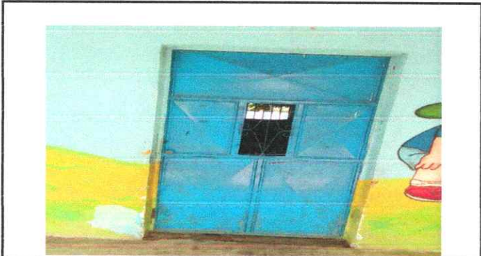
Foto 3: Puerta dañada de chapa y ventana
