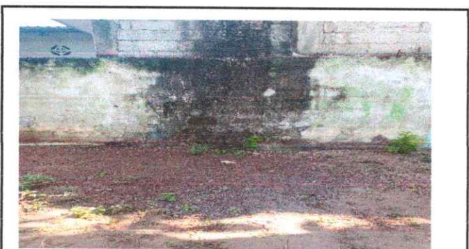
Foto 6: Deterioro de pintura en muro
