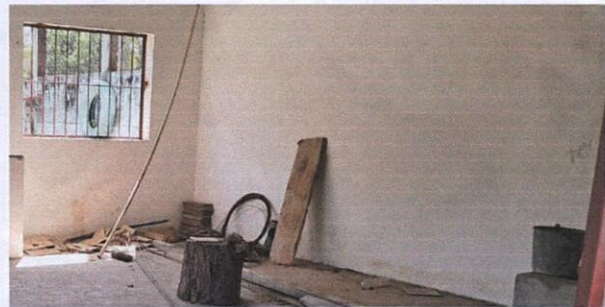
Foto 4: 9.1 Pintura en muros exteriores e interiores de cocina
