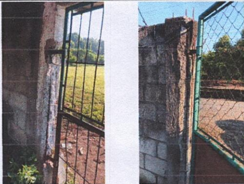
FOTO 10: 21.2 Cernido en muro que sostiene el portón y aula
