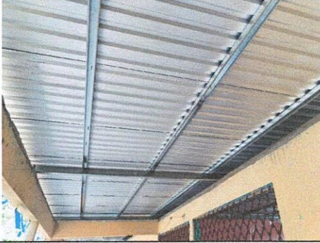
Foto 1: 1.1 Sustitución de lamina, por lamina troquelada aluzinc callibre 26 en aulas y comedor.
