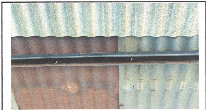
Foto 3: 1.3 Sustrucción de elementos de fijación en aula y comedor
