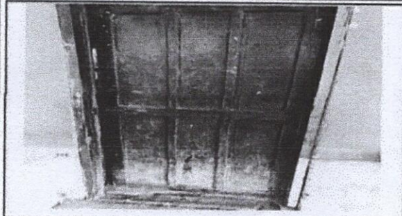
Foto 1: Sustrucción de puerta
