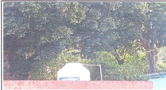
Foto 3: REPARACION Y MANTENIMIENTO DE SISTERNAS/ Depositos de agua. 18.1 Sustitucion de deposito de agua de 1000lt.
