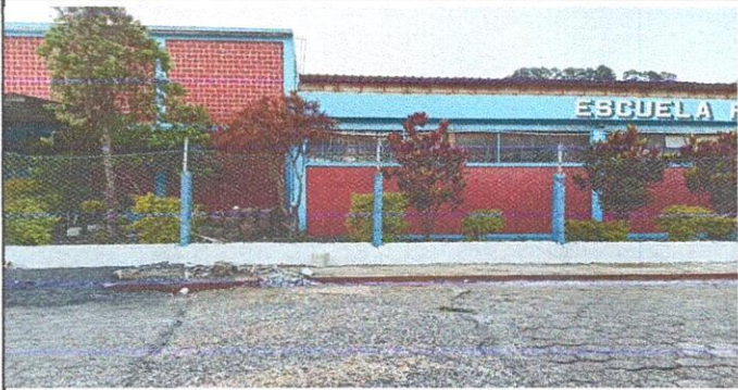
Foto 7: MUROS PERIMETRALES: 15.2 Reparación de muro perimetral de block con tubo y malla galvanizada, solera intermedia y columnas.
