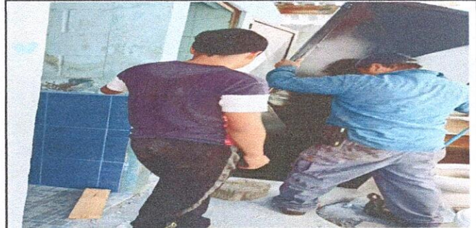
Foto 2. PUERTAS DE META. 4.1 Mantenimiento a estructura 8 (lijado, cambio de tubo, cepillado, sujeciones, aplicación de pintura).
