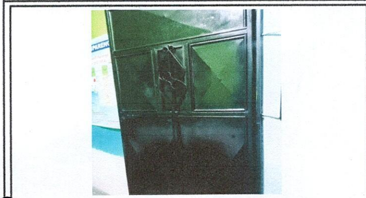
Foto 1: PUERTAS DE METAL: 4.1 Mantenimiento a estructura (lijado, cambio de tubo, cepillado, sujetaciones, aplicación de pintura)
