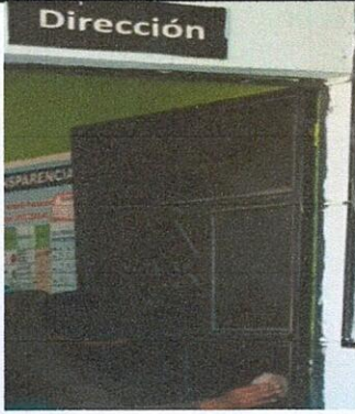
Foto 1: PUERTAS DE METAL: 4.1 Mantenimiento a estructura (lijado, cambio de tubo, cepillado, sujetaciones, aplicación de pintura)
