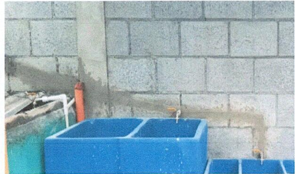
Foto 09. REPARACION DE RED DE DRENAJE Y RED DE AGUA POTABLE. 14.13 Sustitución de llave de chorro
