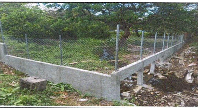
Foto 5: 15 MUROS PERIMETRALES 15.2 Reparación de muro perimetral de block con tubo hg y maya galvanizada soleras intermedias y columnas.
