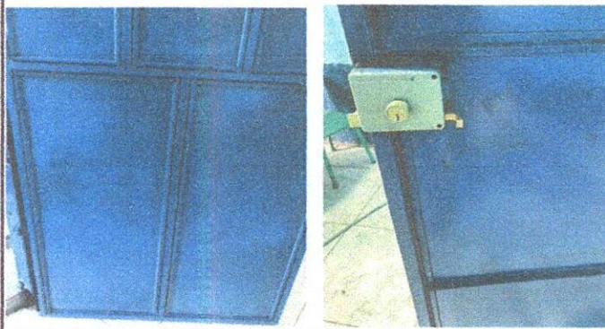
Foto 3: 4. Puertas de metal. 4.1 Mantenimiento a estructura (lijado, cambio de tubo, cepillado, sujeciones, aplicación de pintura, 4.2 Sustitución de chapa.
