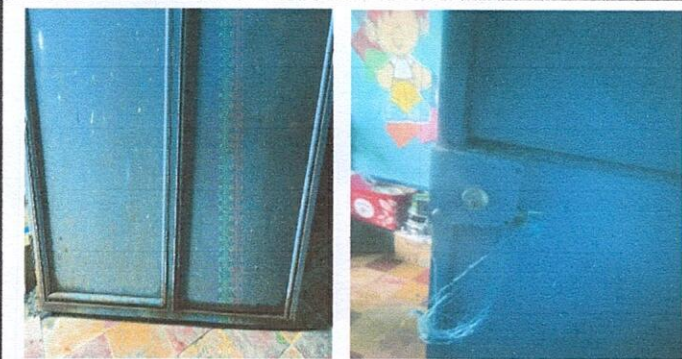
Foto 3: 4. Puertas de metal. 4.1 Mantenimiento a estructura (lijado, cambio de tubo, cepillado, sujeciones, aplicación de pintura, 4.2 Sustitución de chapa.
