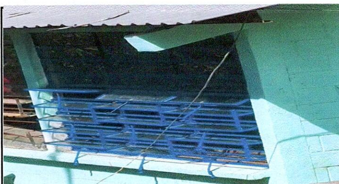
Foto 3: 5 VENTANAS: 5.1 Mantenimiento a estructura de metal de ventana, 5.2 sustitución de estructura de metal de ventana
