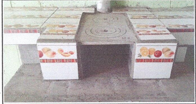
Foto 8: REPARACIÓN DE COCINA 20.2 Sustitución de estufa rural (completa) incluye chimenea y plancha de metal. 20.7 Instalación de azulejo en estufa rural.
