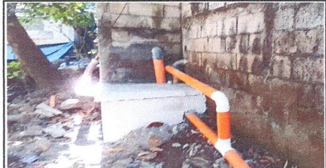
Foto 6: REPARACIÓN DE RED DE DRENAJE Y RED DE AGUA POTABLE. 14.3 Sustitución de tubería PVC línea principal de aguas negras. 14.8 Sustitución de caja de registro.
