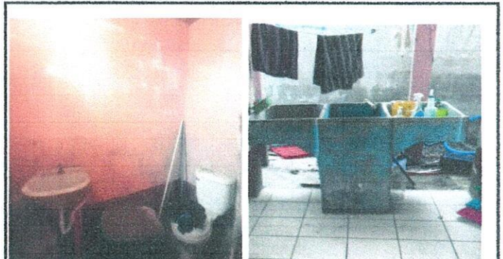
Foto 4: 19 MANO DE OBRA ESPECIALIZADA (ALBAÑILERÍA, HERRERÍA, ELECTRICIDAD Y PLOMERÍA) 19.15 Instalación de inodoro. 19.17 Instalación de lavamanos. 19.20 Instalación de pila.
