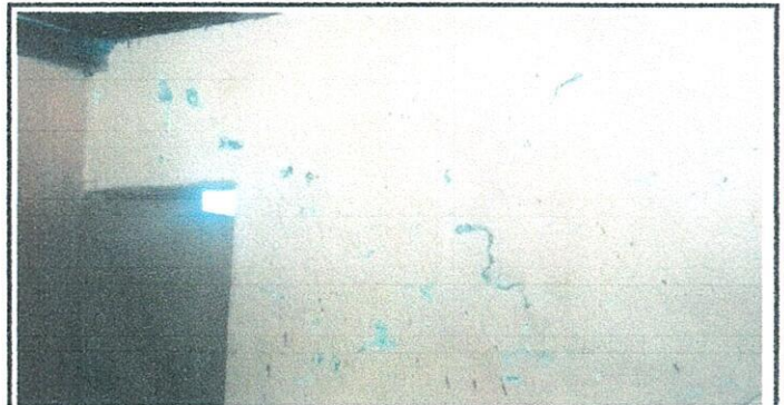
Foto 6: 21 REPARACION DE REPELLO Y CERNIDO DE PAREDES. 21.1 Repello en muro. 21.2 Cernido en muro.
