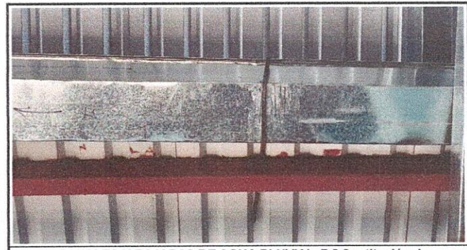
Foto 6: CANALES Y BAJADAS DE AGUA PLUVIAL 7.5 Sustitución de soporte o pescante de metal para canal.
