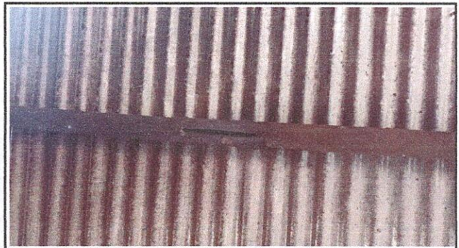
Foto 2: CUBIERTA DE LÁMINA 1.3 Sustitución de elementos de fijación.
