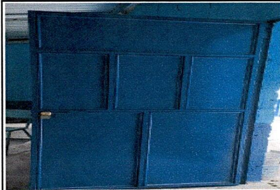
Foto 3: PUERTAS DE METAL 4.1 Mantenimiento a estructura (lijado, cambio de tubo, cepillado, sujeciones, aplicación de pintura) 4.2 Sustitución de chapa 4.3 Sustitución de Puerta.
