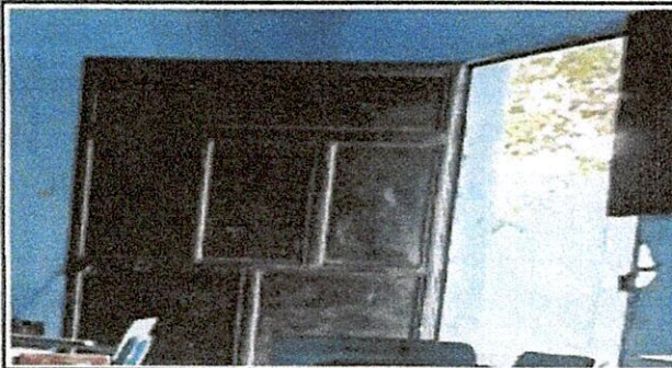
Foto 3: PUERTAS DE METAL 4.1 Mantenimiento a estructura (lijado, cambio de tubo, cepillado, sujeciones, aplicación de pintura) 4.2 Sustitución de chapa 4.3 Sustitución de puerta
