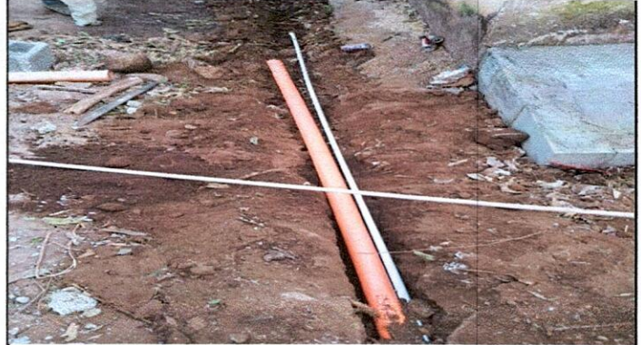
Foto 8: 14 REPARACIÓN DE RED DE DRENAJES Y RED DE AGUA POTABLE: 14.4 Sustitución de tubería pvc línea principal aguas pluviales
